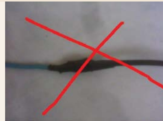
Gambar – Contoh sambungan kabel yang tidak memenuhi syarat
